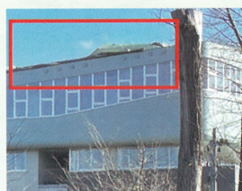
強風で破損した「そらまめ」の屋根
